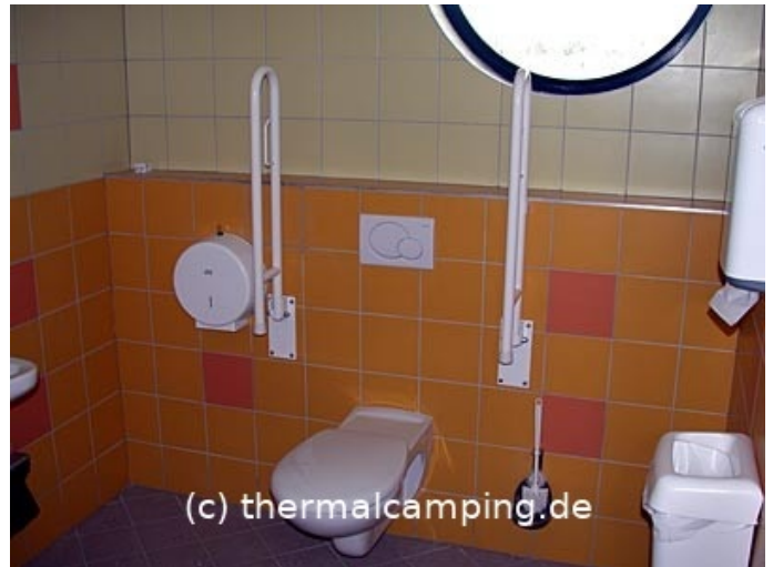
Behinderten - Dusche mit WC
